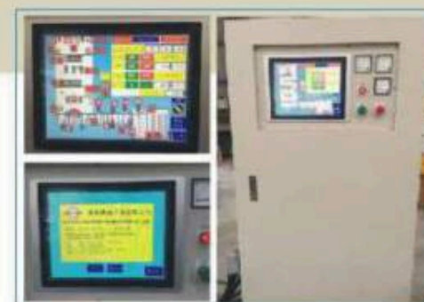
Control panel 控制面板
